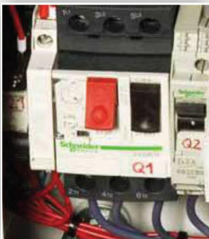
● Protector Magnetotérmica mediante disyuntores.
